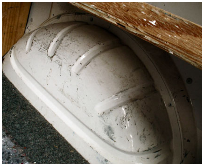
Nutzungsbedingter Abrieb und Kratzer
